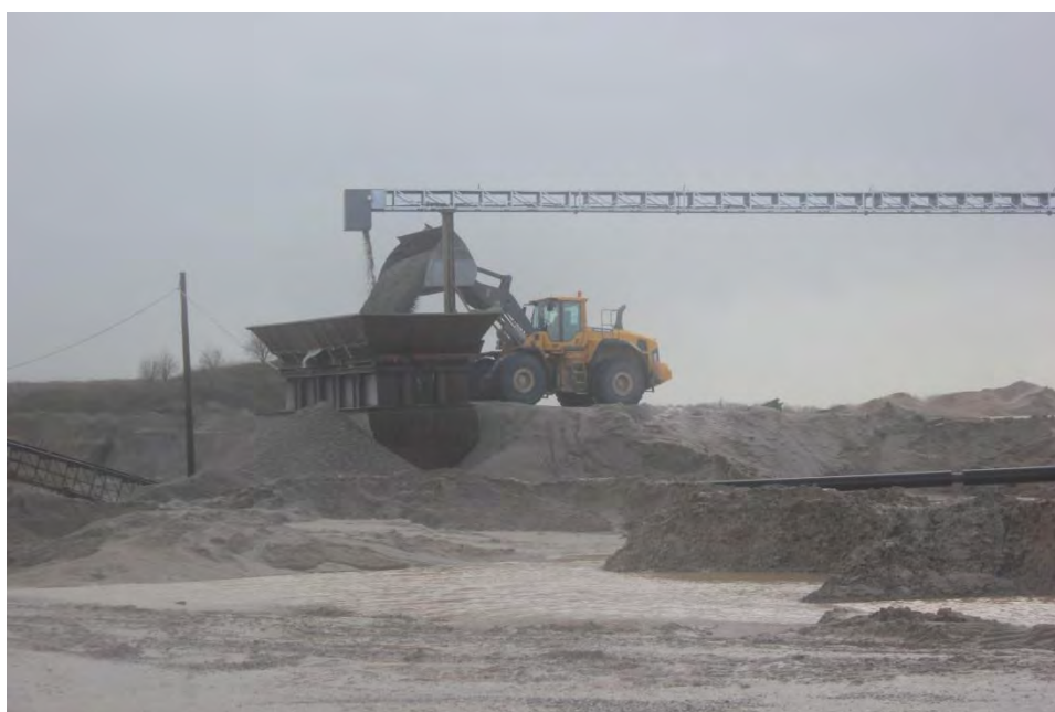
Figur 4.11: Fødekassen til anlægget til betontilslag. Fra højre kommer materialet via transportbånd fra trin 2 i produktionslinjen til betontilslag, og samtidig sker der direkte tilførsel af materiale til fødekassen med en frontlæsser.
