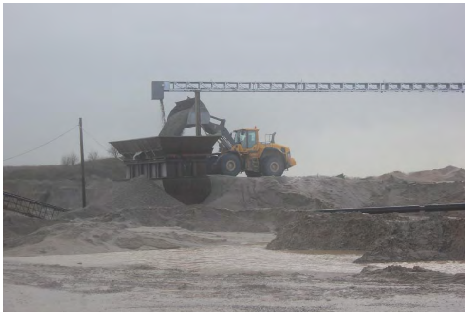
Figur 3.10: Fødekassen til anlægget til produktion af betontilslag. Fra højre kommer materialet via transportbånd fra trin 2 i produktionslinjen til betontilslag, og samtidig sker der direkte tilførsel af materiale til fødekassen med en frontlæsser.
