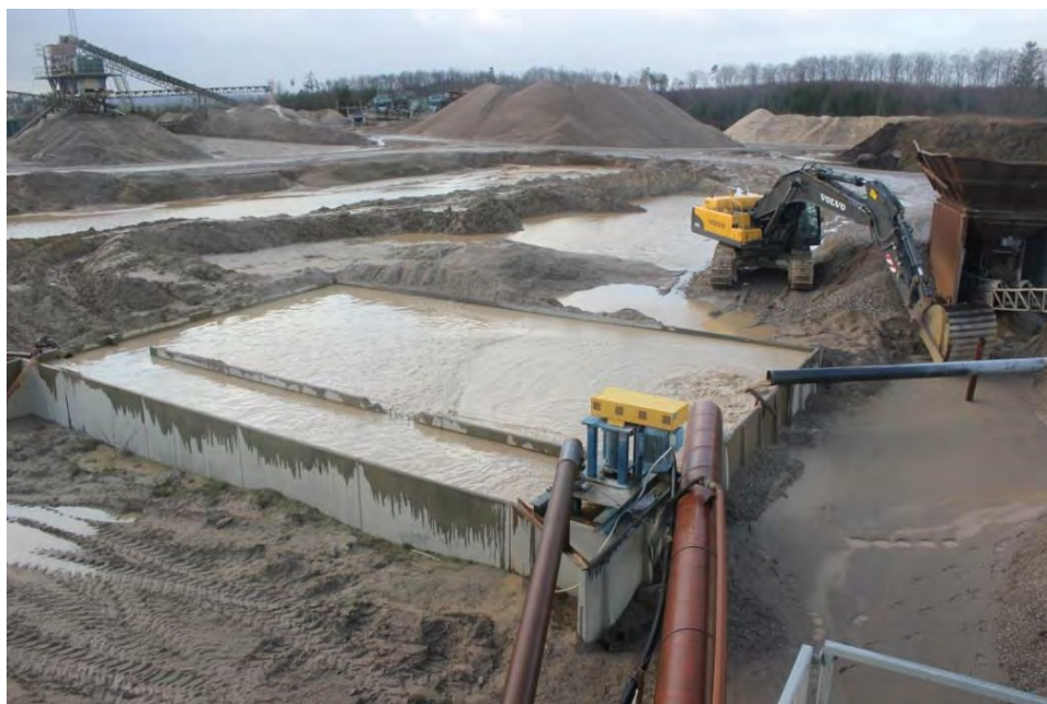
Figur 3.9: Slambassin ved anlægget til produktion af betontilslag hvor vandet fra densitetssorteren og sorteringsanlægget ledes hen.
