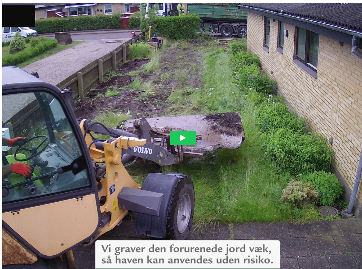
Figur 18 Film optaget på tidligere tjæreplads, hvor entreprenøren er klar til at afgrave tjæreforurenet jord.
