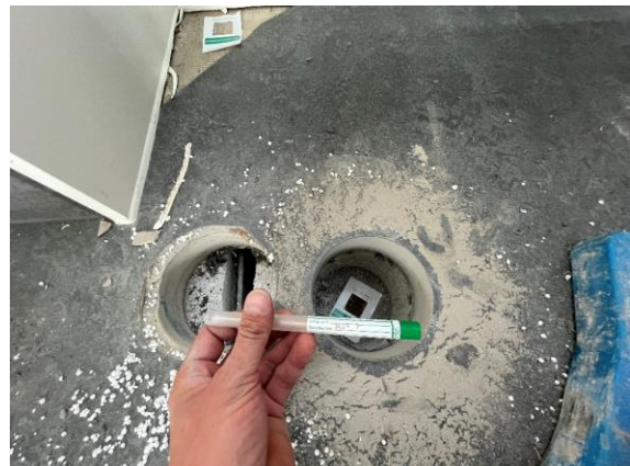
#6 Her prøvetages for skimmel på in-situ støbt betondæk.
