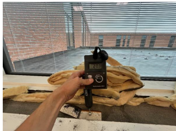
#12 Under isolering er der asfaltpap mod porebeton.
