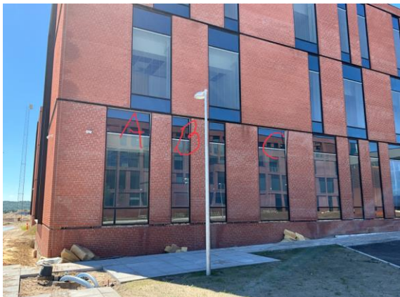
#1 D07. Prøver MY1-MY5 er udtaget fra sider og bund på inddækning efter demontering af blindfelt.
