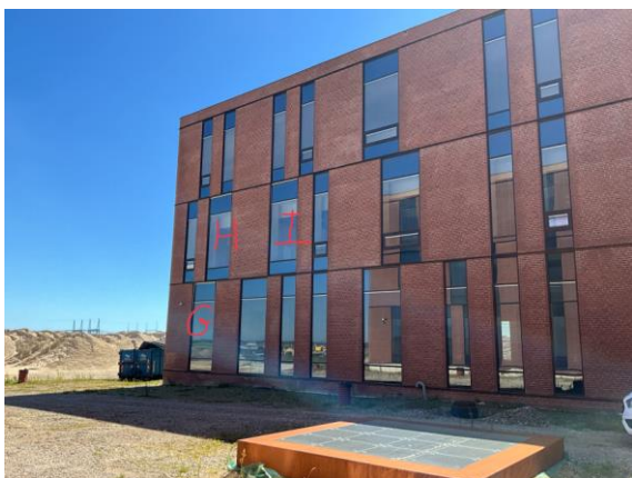
#3 D02. Prøver MY7-MY15 er udtaget fra sider og bund på inddækning efter demontering af blindfelt.
