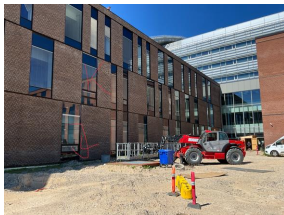
#4 D03. Prøver MY16-MY19 er udtaget fra sider og bund på inddækning efter demontering af blindfelt.
